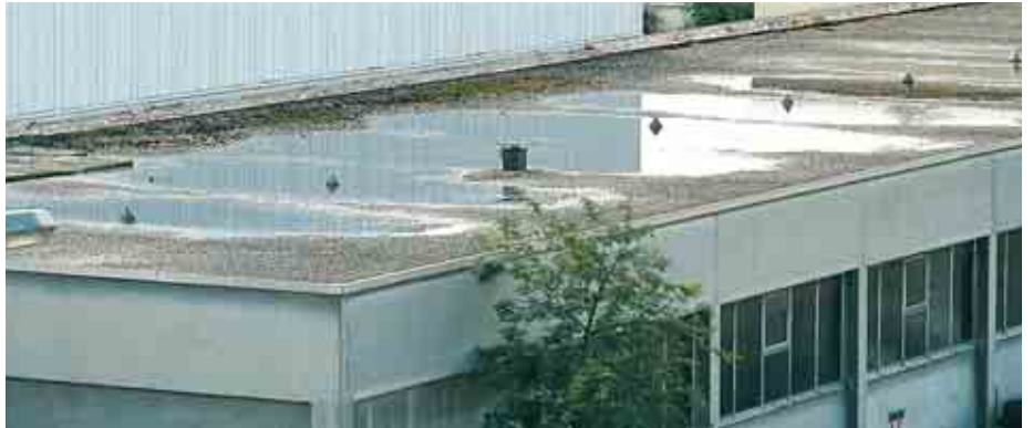
Flachdächer zeigen häufig – obwohl mit Gefälle geplant – Pfützenbildung! Darauf muss bereits bei der Planung geachtet werden.
