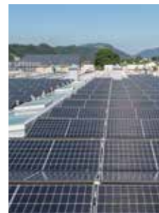
Unter Photo- voltaikanlagen
