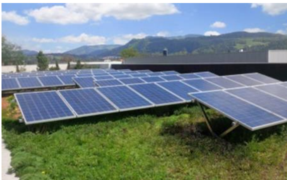
Abbildung 39: Kombination aus extensiver Dachbegrünung und PV-Anlage (Quelle: Optigrün international AG)
