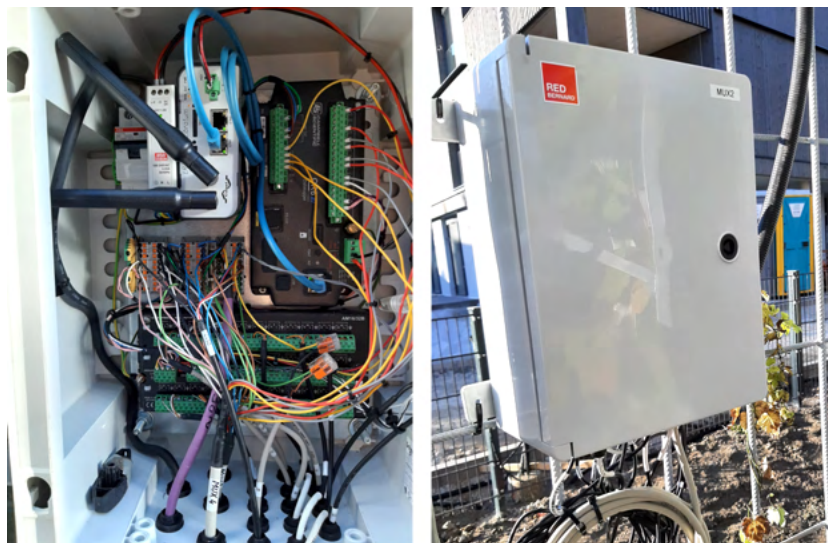
Abbildung 19: Datenzentrale SÖLL | TIROL, die Datenlogger wurden in witterungsbeständigen Schaltschränken verbaut, Solarstrahlung ( I_{sol} ). ©BOKU-IBLB, 2025.
