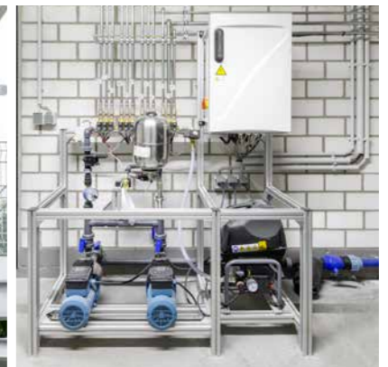
Technikraum für das vollautomatische Versorgungssystem Fotos © Stefan Schilling
