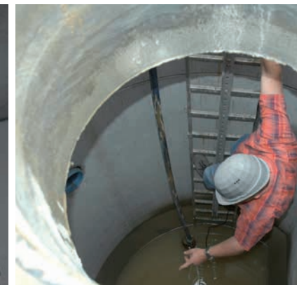
Staukanal Regenwassermanagement, Fassungsvermögen 75 m 3
