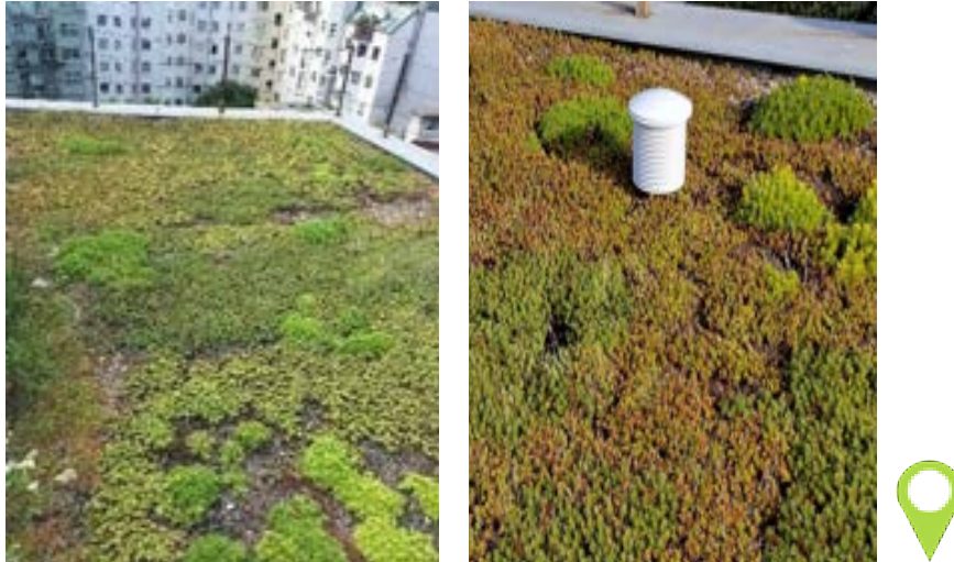
Abbildung 93: Steinbauer Development extensiv, links: extensive Dachbegrünung sowie Umgebung, rechts: Lufttemperatursensor und Sedum -Bedeckung (©IBLB).
